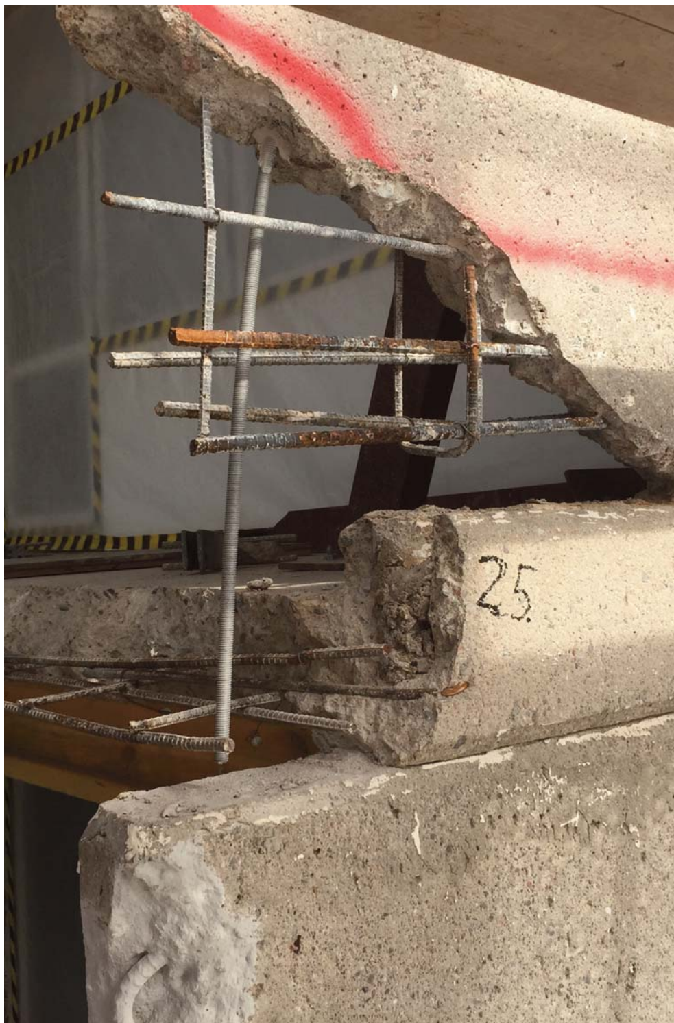
Betongen i många av föreningens balkonger var i dåligt skick.
